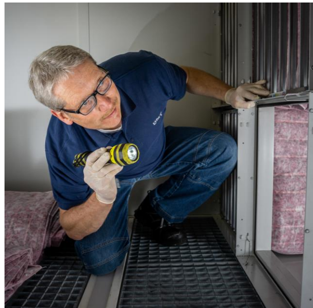
Hygieneinspektion an RLT-Anlagen
